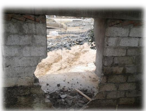
Fig. 4: Restos de una de las casas de San Pablo de Amalí que fue destruida en el evento de marzo, 2015.
